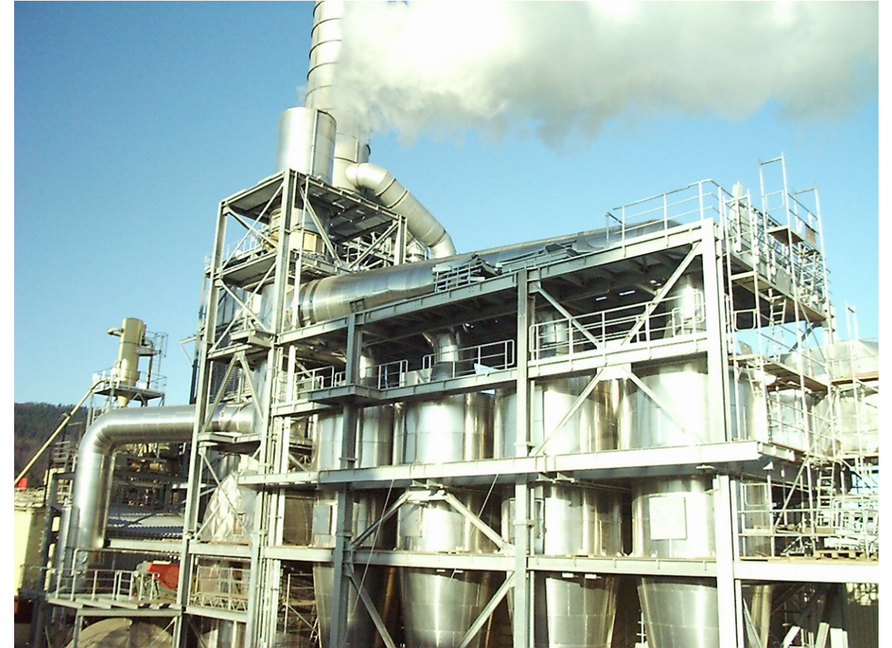
Foto Gerüst mit Brennkammer, Abscheidezyklonen und Notkamin über dem Trommeltrockner
